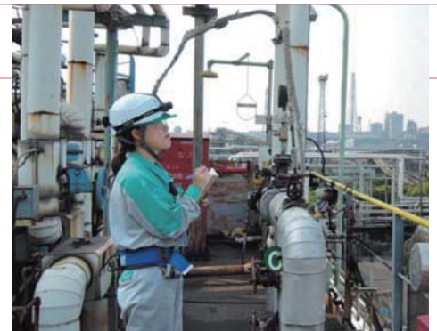
弊社ビスフェノール工場にて現場計器をチェック ※ビスフェノールは主にポリカーボネートの原料です。
